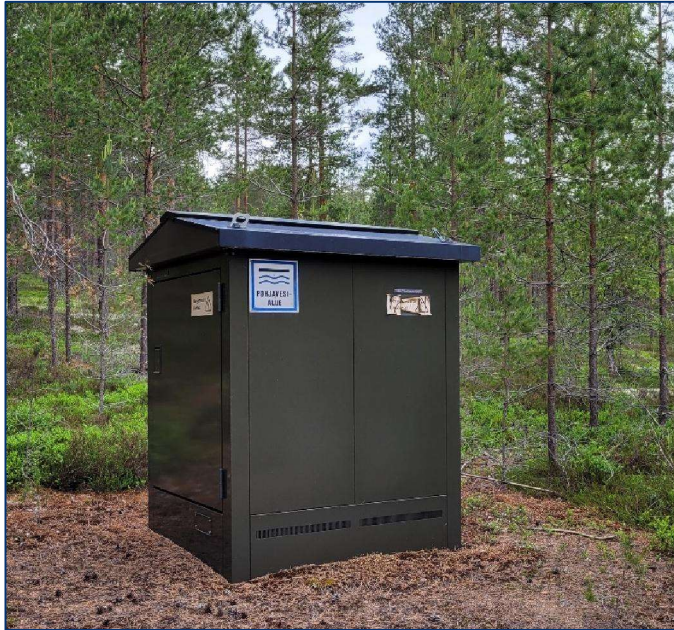
Kuva 5. Puistomuuntamo Vatulanharjulla kesällä 2024.
