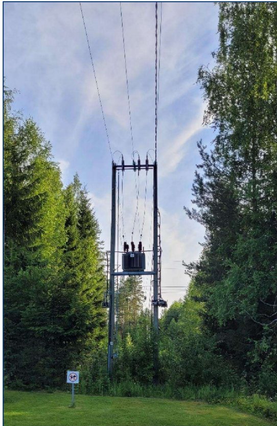
Kuva 6. Pylväsmuuntamo Teikankaan pohjavesialueella kesällä 2024.
